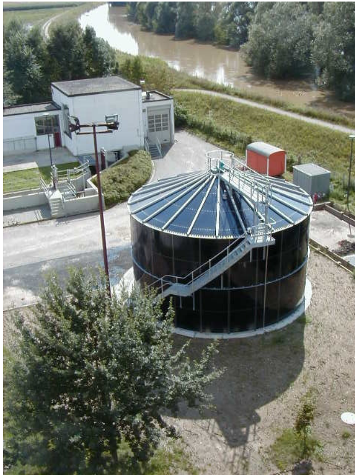
Schlammstapelbehälter für externe Schlämme auf der Kläranlage Straubing Abb.5.1
