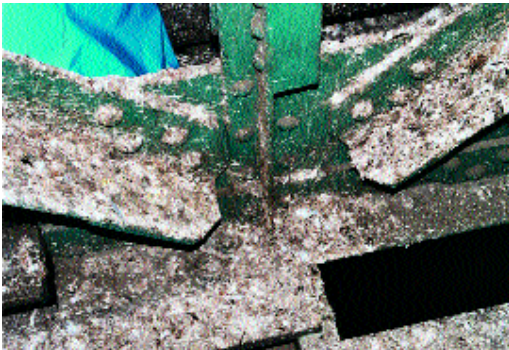
Abb. 2: Durch Taubenkot verschmutzte Stahlträger
